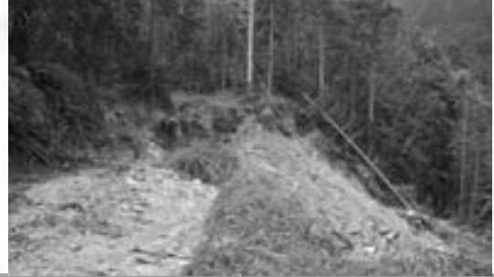
圖四 12K+100路基沖蝕及下邊坡土石滑落
