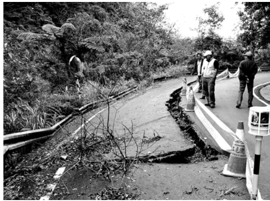
圖 2. 柏油路面及護欄下陷
