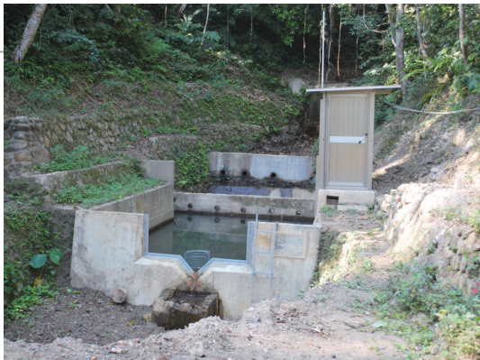
量水堰是試驗集水區量測流量最常見的設施。(陸象豫 攝)
