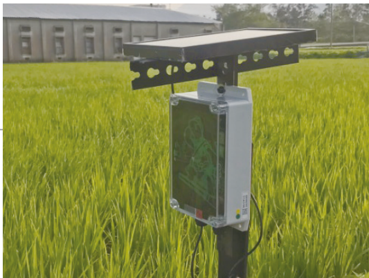
圖3 微氣象站以無線傳送回雲端，利用太陽能提供電力。
