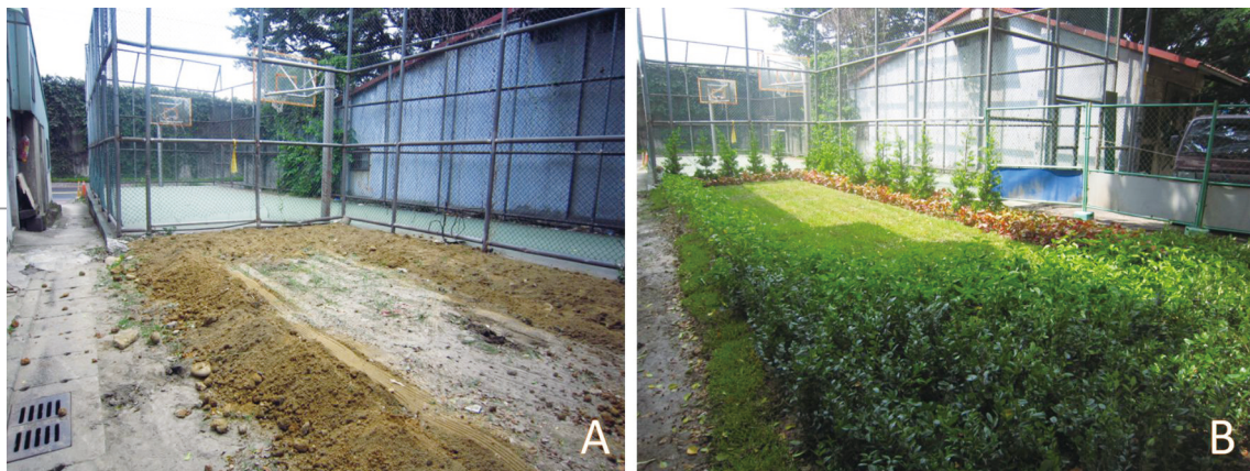
圖3 街角死巷可透過植栽工程施工，搖身一變成為小型的公園綠地(A.施工前；B.施工後)。
