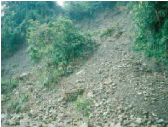
颱風豪雨引發山地道路邊坡崩塌(盧惠生 攝)
