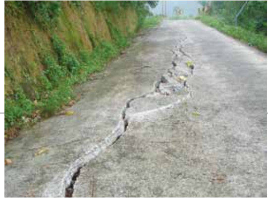
張力裂縫是邊坡崩塌的徵兆之一，道路鋪面及擋土牆等人為構造物最易顯現此現象。(林照松 攝)
